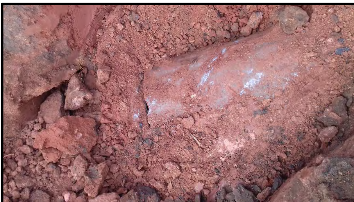
Figura 19.2 – Tubo sem rejunte e não são armados.
