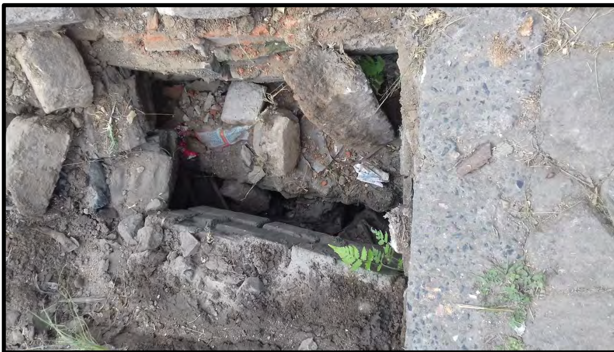
Figura 19.1 – Caixa assoreada e entupida.
